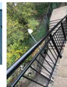
Persborg Station Målning av trappräcken och väggar vid perrongen. Utfört av Tobias Nilsson, Europaint. Färg: Tikkurila Temadur 20
